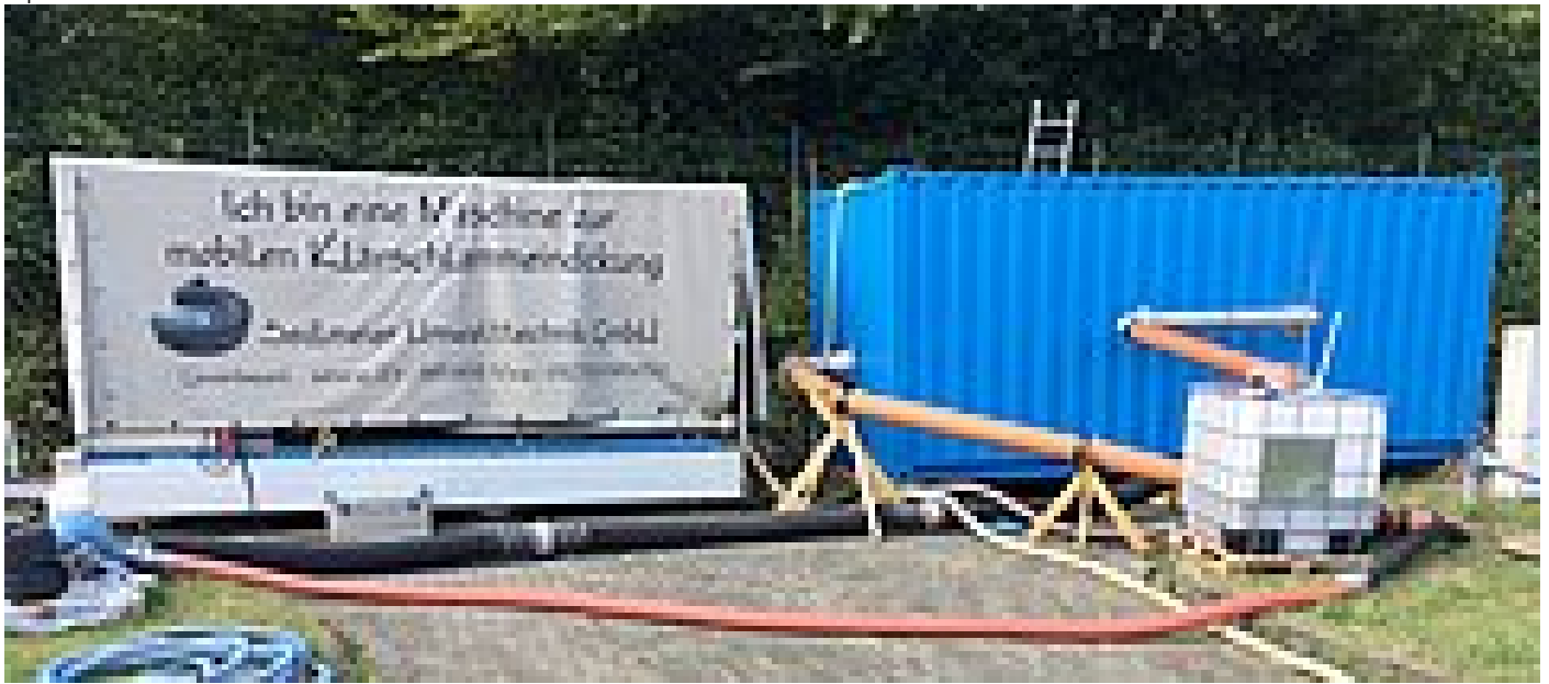
Bild 2: Überbrückungsbetrieb - Pumpenbeschickung der Vorführanlage HUBER Trommelsieb LIQUID (rechter Container) und Ablauf des gesiebten Abwassers im Freispiegel, Dünnschlammverdickung mit mobilem HUBER Scheibeneindicker S-DISC (im linken Container)
