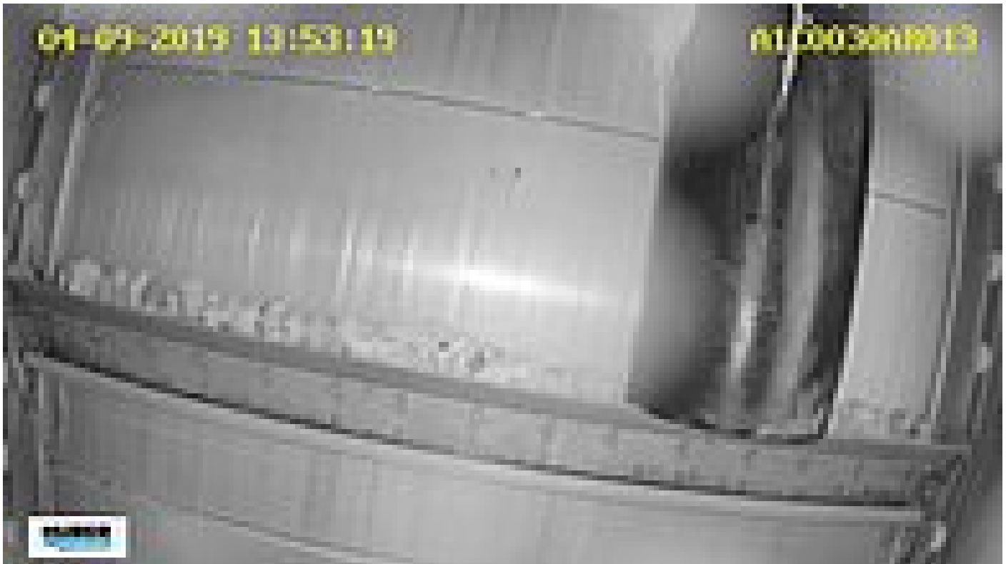
HUBER Störstofferkennung Safety Vision bewahrt HUBER Harken-Umlaufrechen RakeMax® vor größeren Schaden durch Rohrdichtkissen
