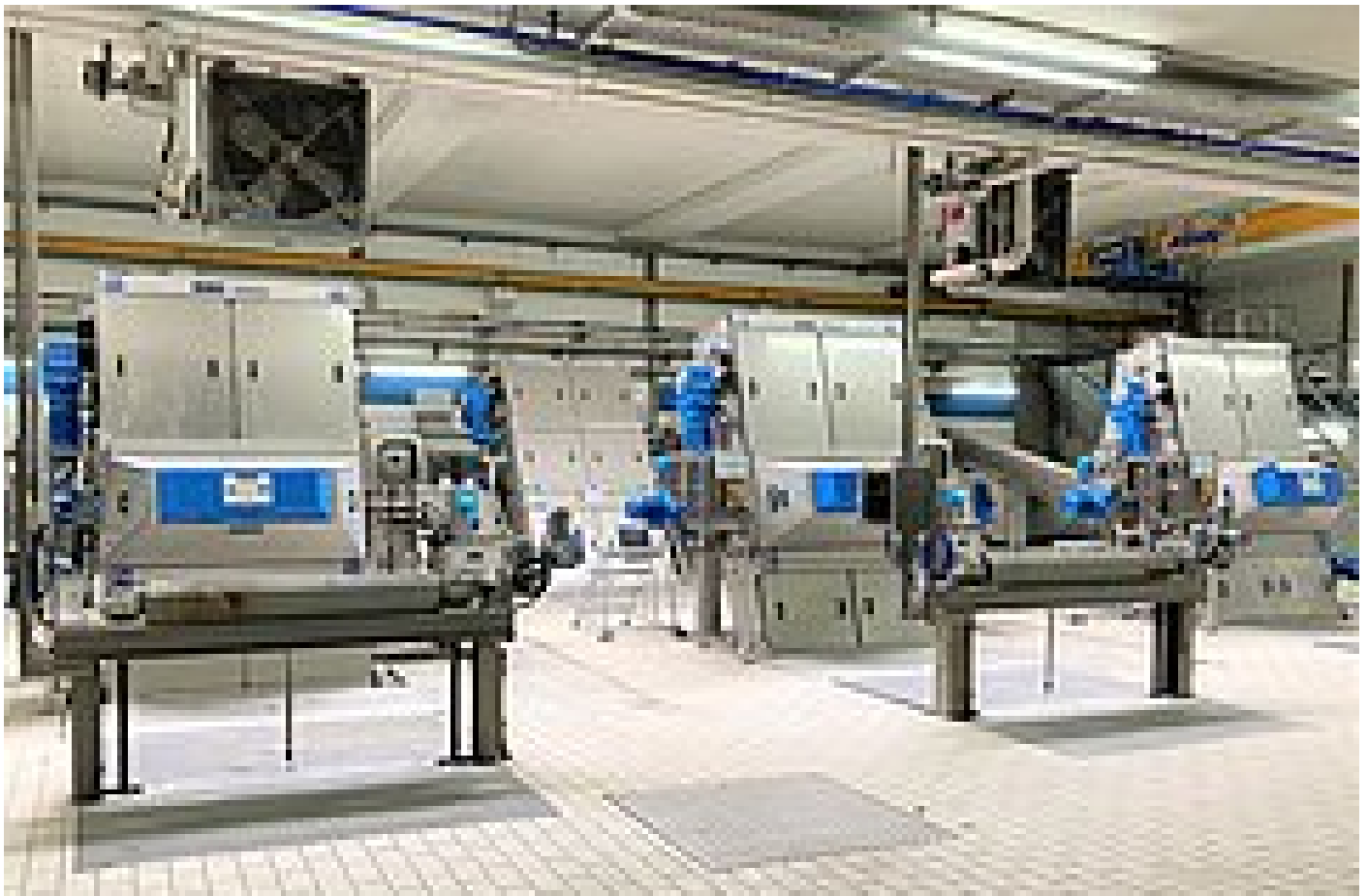
HUBER Safety Vision System auf der Kläranlage Nürnberg
