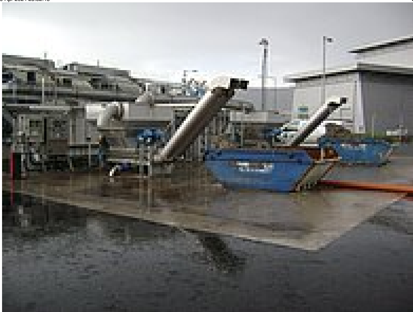
2x HUBER Waschpresse der Baureihe WAP-SL für jeweils 15 m 3 /h Rohrengut, über Schwemmrinne
