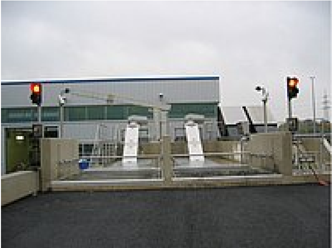
Zwei 20 m 3 Annahmehunker mit Austragsschnecken
