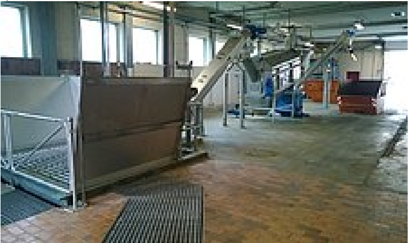
Sandannahmeverfahren RoSF5 VW an der Kläranlage Koblenz
