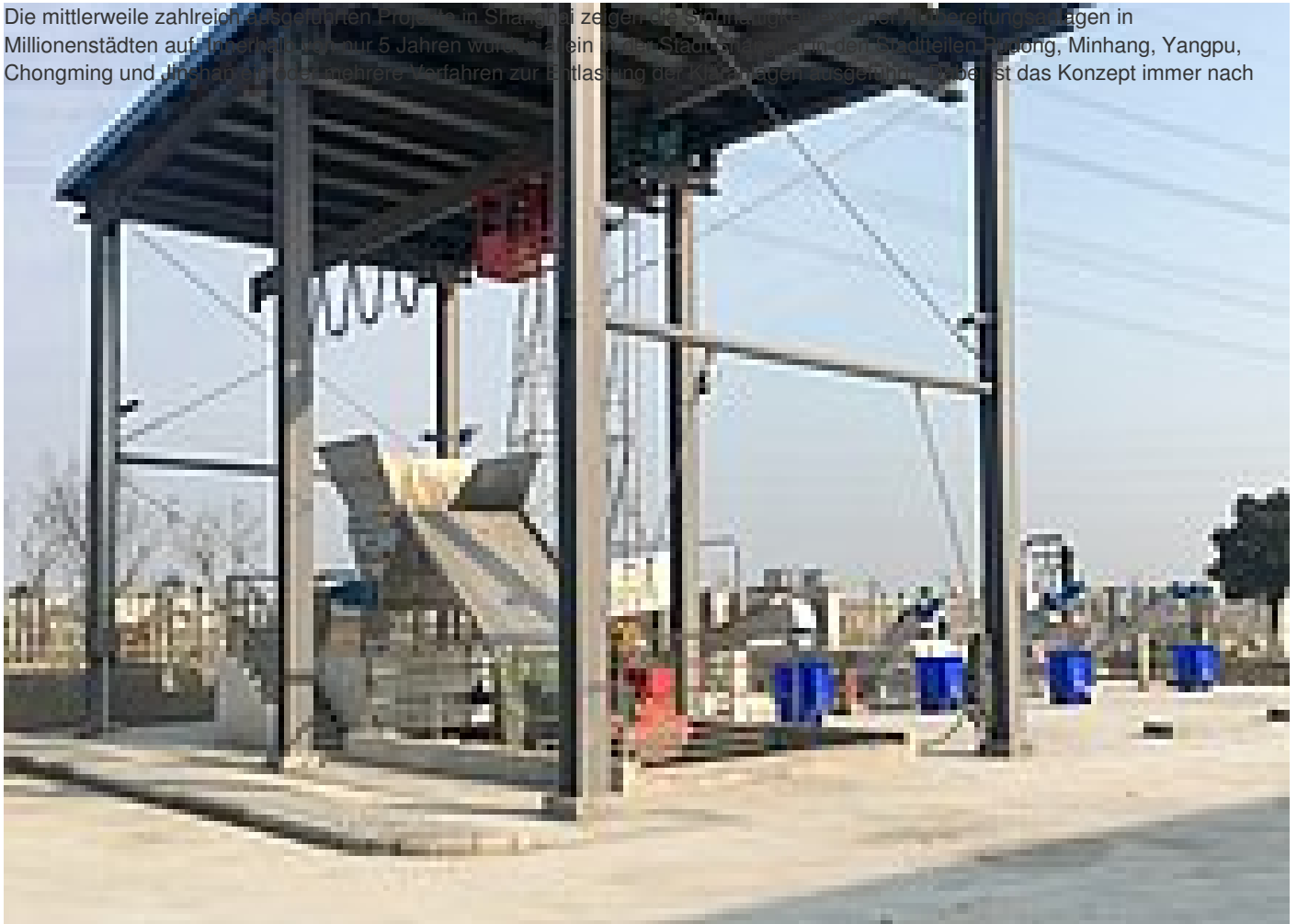
HUBER Sandaufbereitungsanlagen der chinesischen Stadt Kunshan
