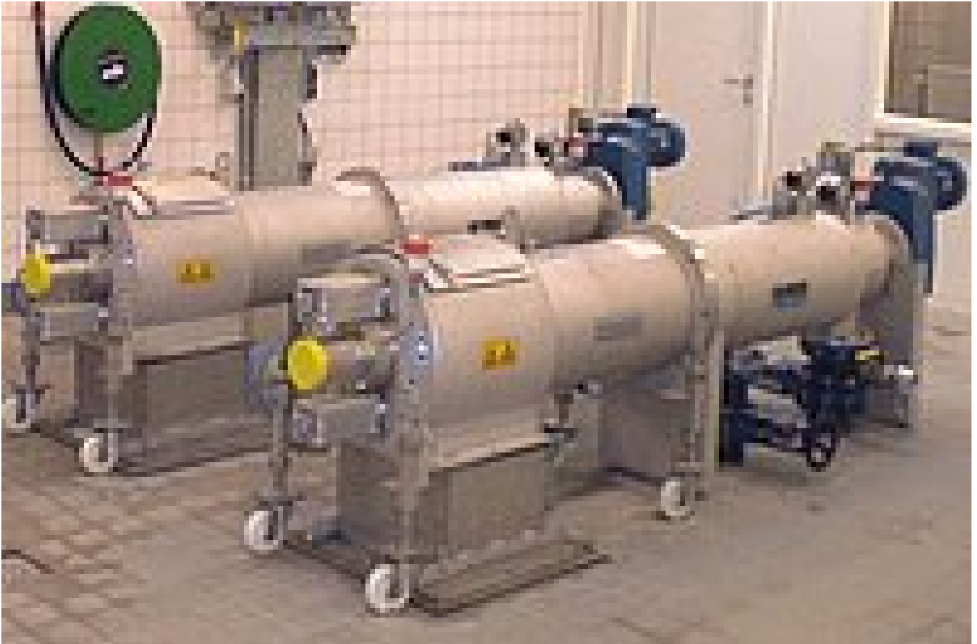
Zwei von vier installierten Fremdstoffabscheidern
